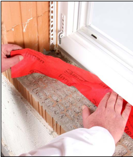
7. Luftdichtes Verkleben des 3line Brüstungsbandes am Fensterbankanschlussprofil. (li. u. re. ca. 10 cm Überlänge)
