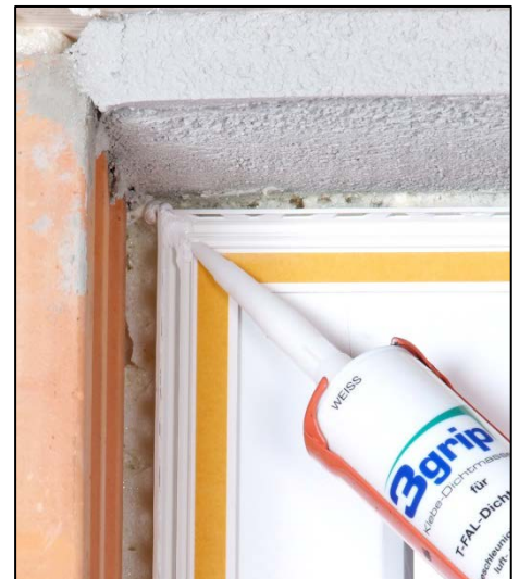
12. Abdichten alle Stöße der T-FAL® Dichtprofile mit 3grip Klebe-Dichtmasse .
